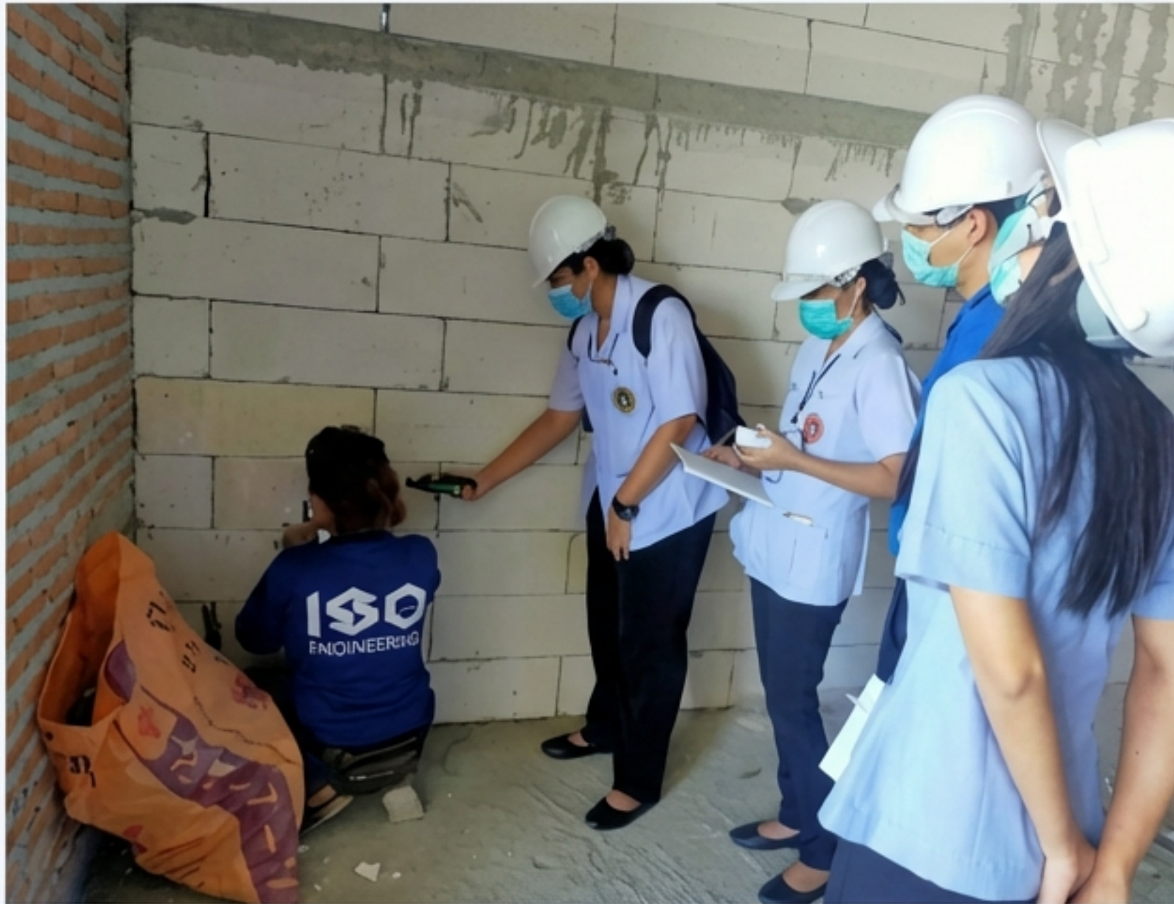
การใช้เครื่องมือตรวจวัดระดับเสียงในพื้นที่ก่อสร้าง
